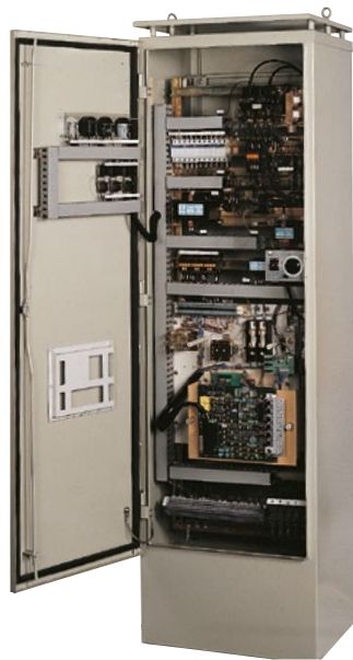
Armoire de contrôle
