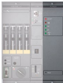
Alimentation de secours
