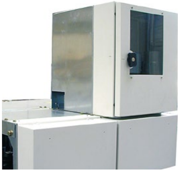
Easergy T200 S pour SM6-24 : interface de contrôle-commande dans le coffret BT
