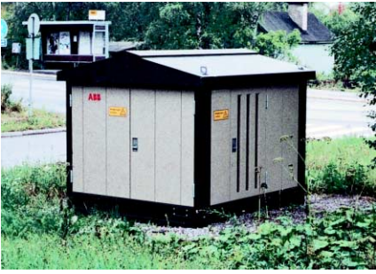
Installations et équipements techniques
